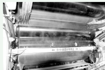
カレンダーロール機の出口付近
